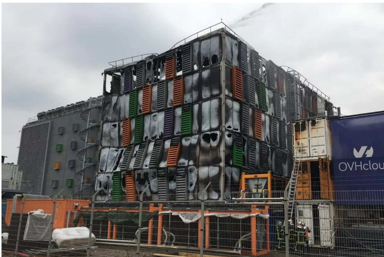
[Огонь полностью уничтожил дата-центр крупнейшего хостинг-провайдера Европы OVH]
