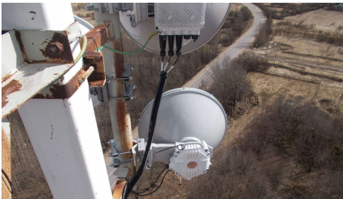
На фото РРЛ РРС-10G-E 10 Гбит/с на испытания в МТС, 2017 год. Источник: сайт ДОК
