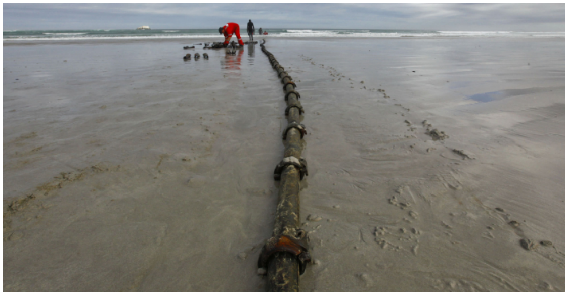
Подводная кабельная система West African Cable System, соединяющая Африку с Европой, модернизацию которой проводила Huawei Marine
