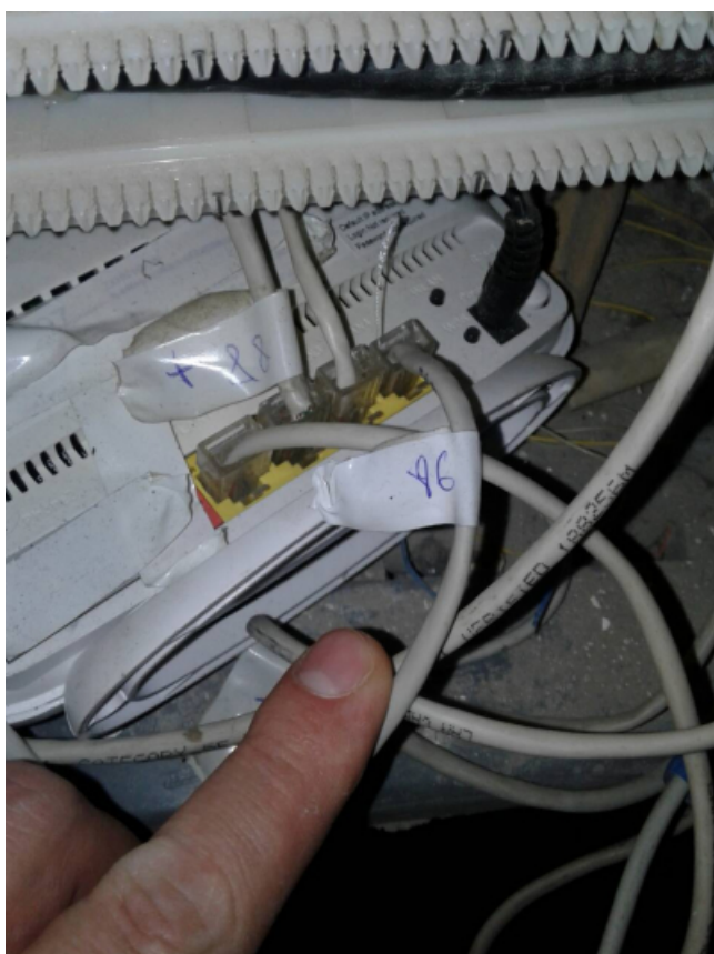
[Подвальные сети, открытые щиты]
