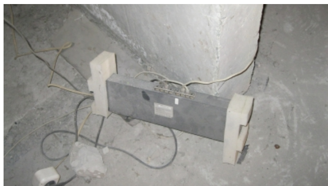
Фотографии с телефона, качество не очень. Небольшой оператор. Крепление и ввод кабеля.
