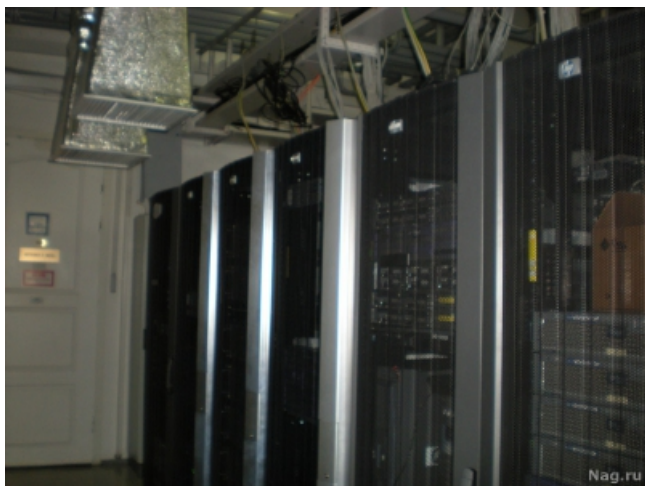
Собственное оборудование МТТ на серверах НР - серверы систем управления, хостинг и т.д.
