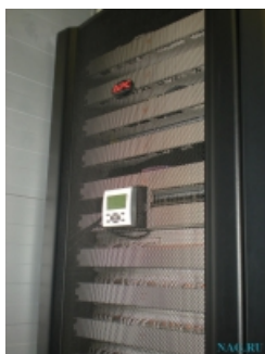
Стойка, где располагается оборудование, "присматривающее" за всеми нормативными параметрами работы ЦОДа.
