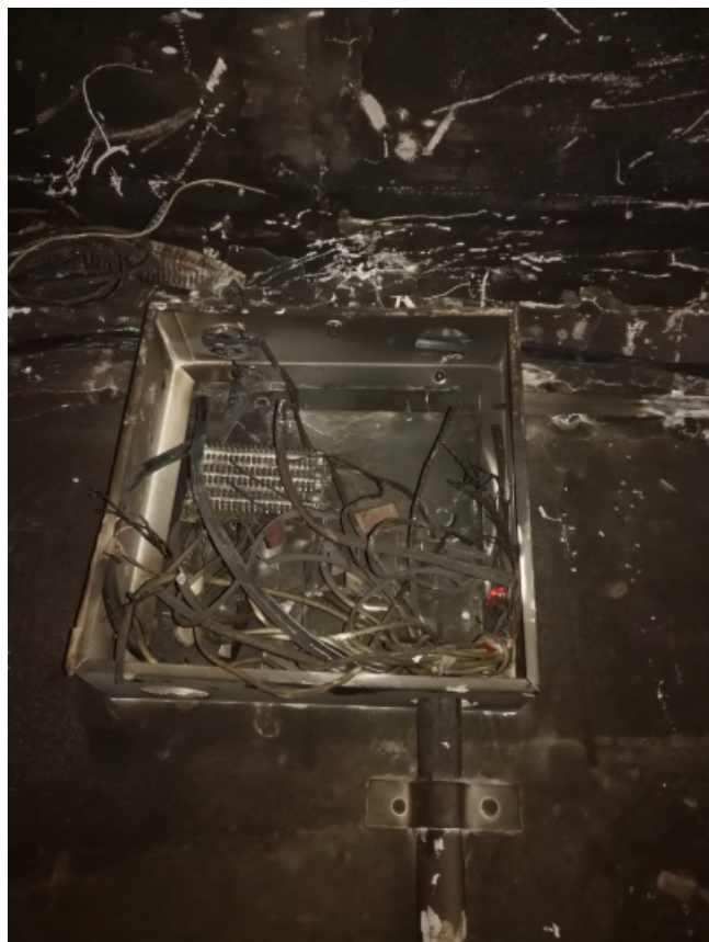
[Чердак и последствия пожара]
