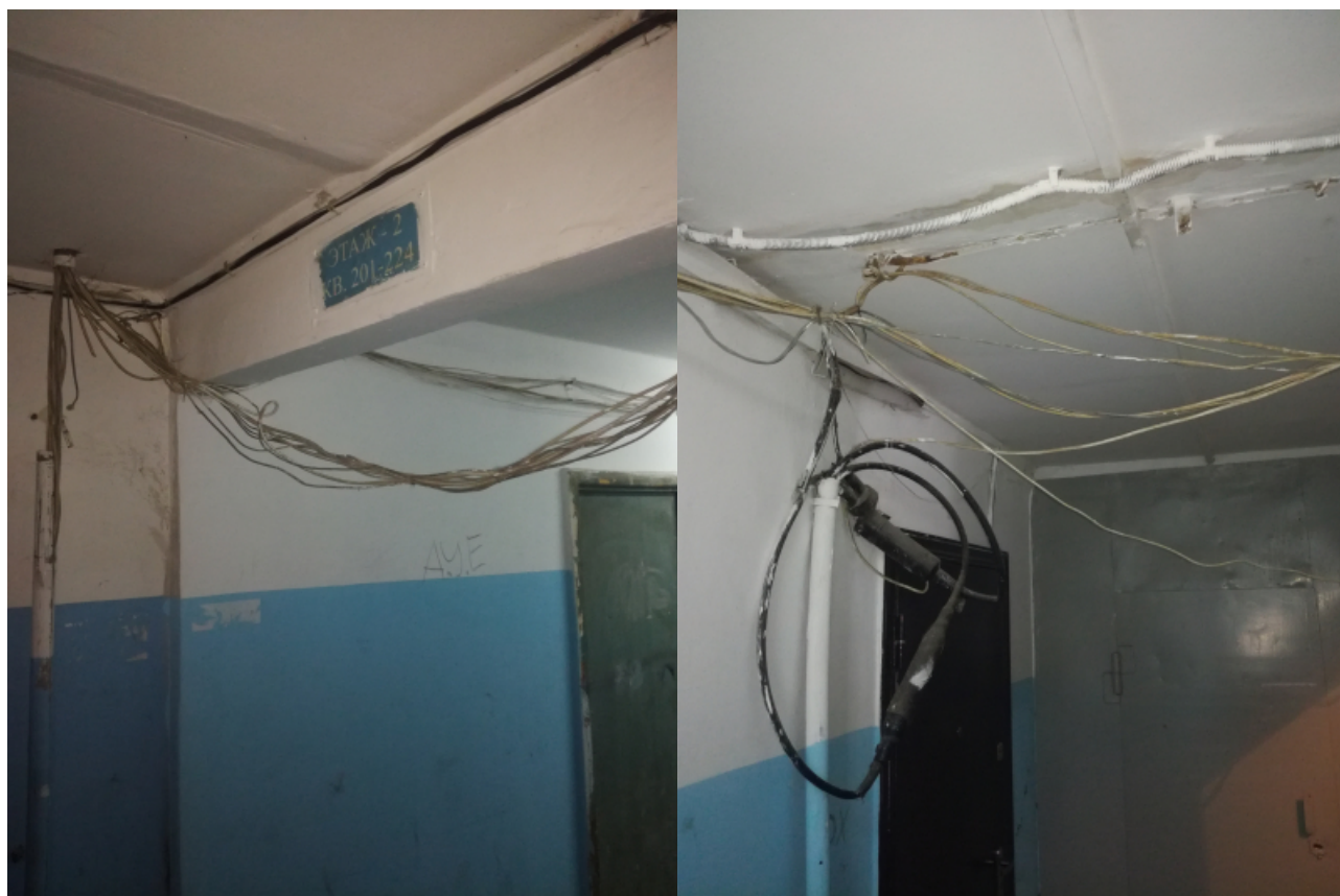
[Нецелевое использование кабель-канала]
