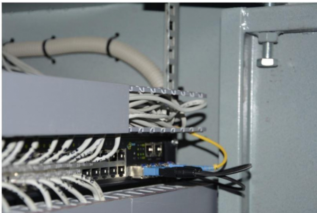
Так подключают "Оптический гигабит"
