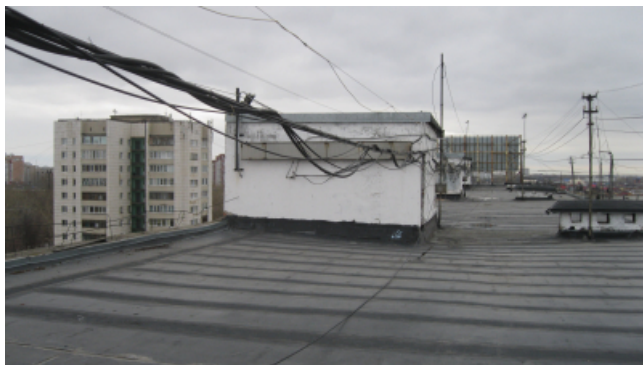
[Кабели на крыше]
