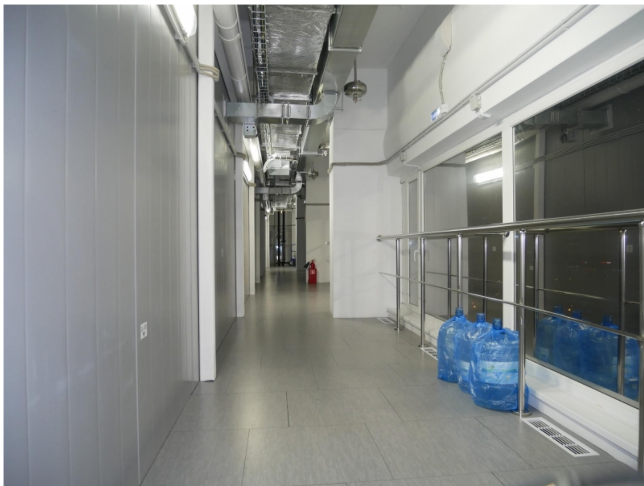
По периметру всего помещения установлена система пожаротушения на основе Хладона. Все здание
