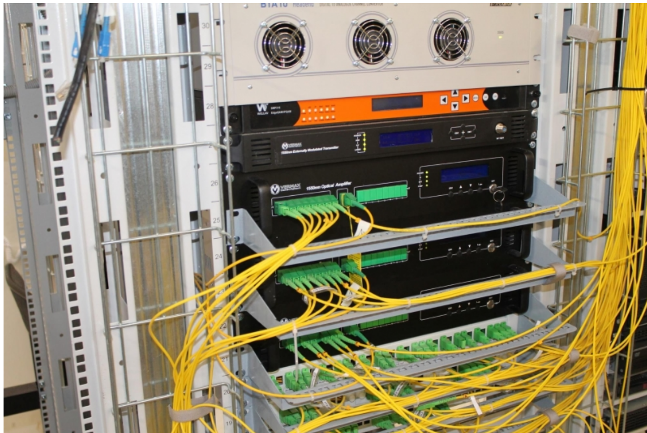
Головные станции кабельного телевидения в серверной "Интерры"
