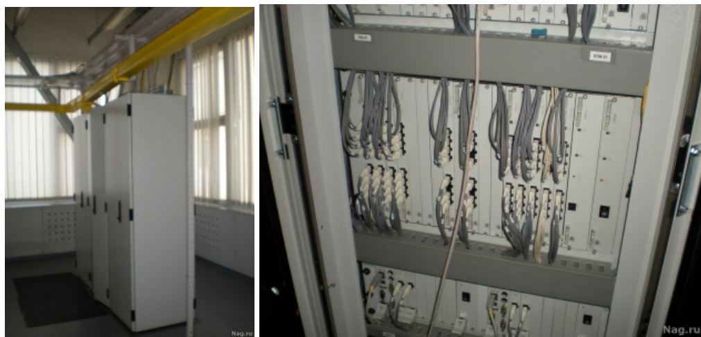
Коммутатор от Strom Telecom...И его "внутренности"
