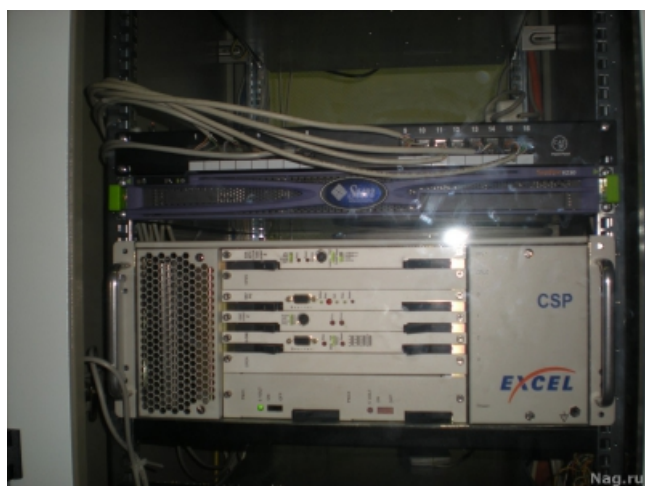
Оборудование Excel CSP 2090 от компании Cantata Technology
