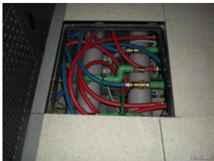
Фальшпол с системой водяного охлаждения
