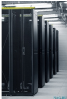
20 стоек из тех 70, что смонтированы, уже сданы коммерческим клиентам, а еще по 30 ведутся переговоры.
