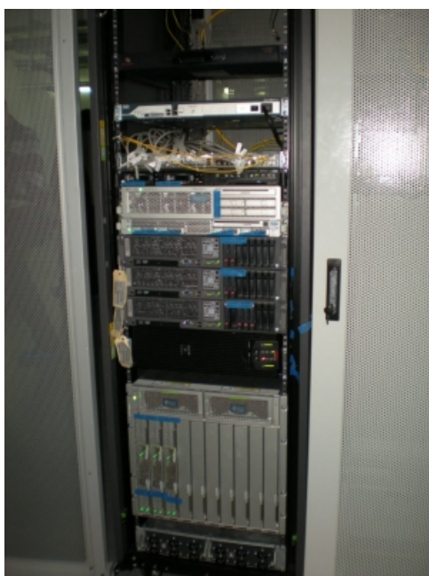
Стойки с оборудованием
