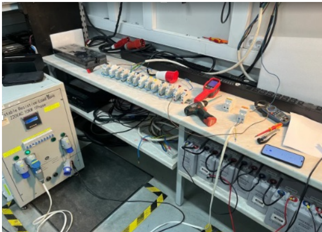
Рисунок 3. Процесс тестирования теплового расцепителя АВ
