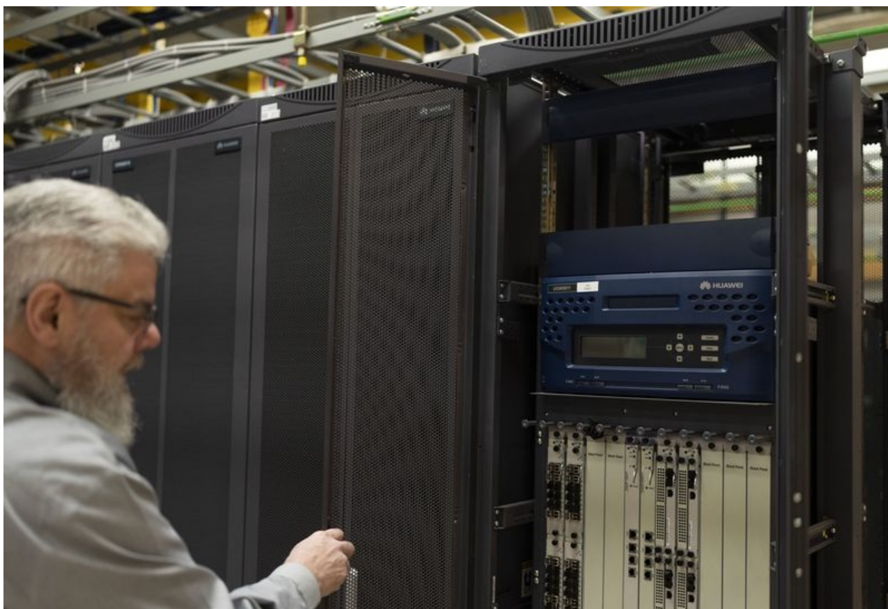
Оборудование Huawei у американского оператора United Wireless Communications
