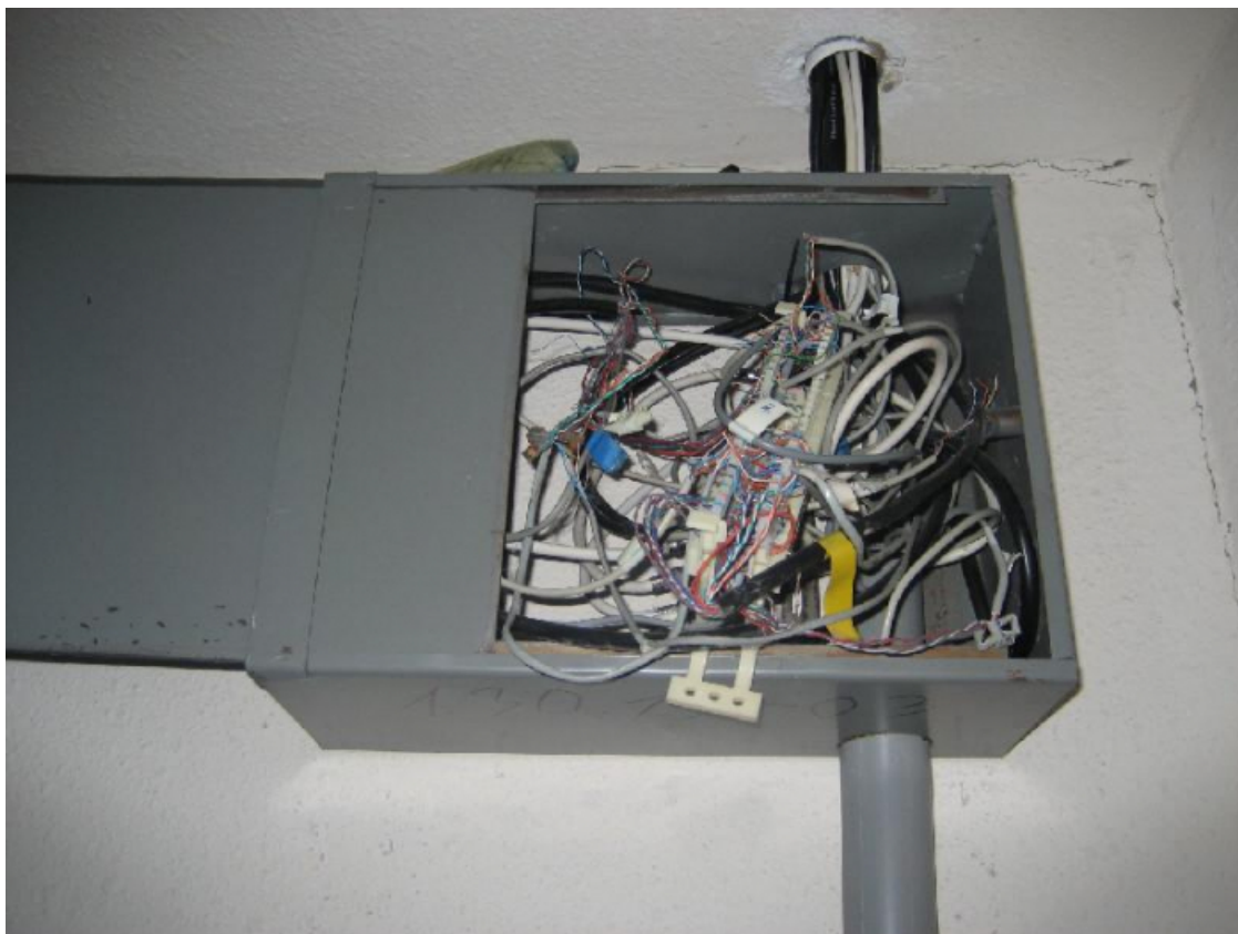
Этажный распределительный шкаф, внутри нет никаких креплений. "Солома" во всей красе
