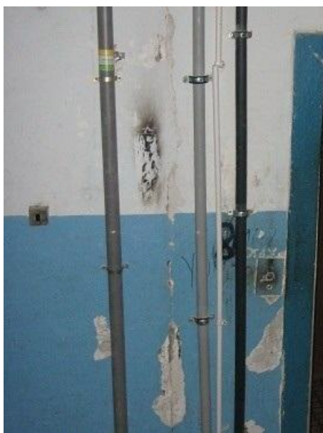
ТСК операторов связи в подъезде жилого дома
