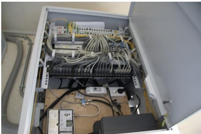
Классический телекоммуникационный шкаф со стоечными кроссами
