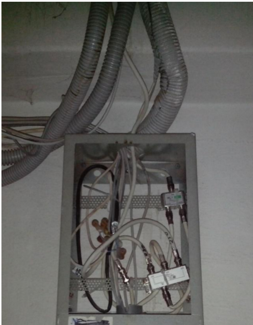
Этажный распределительный шкаф. Делители закреплены на перфоленту к подъездной стене
