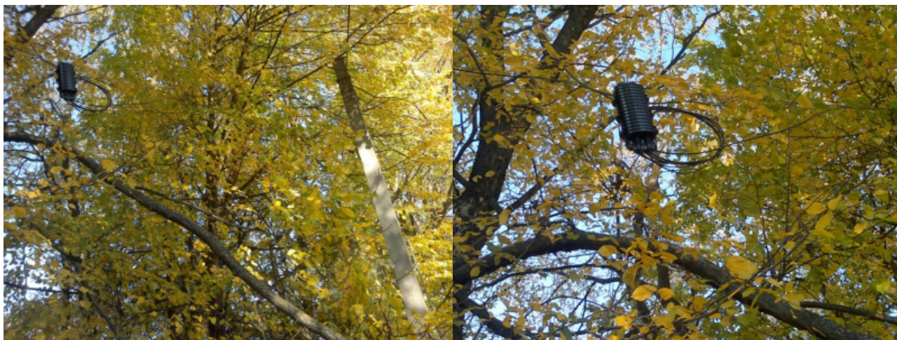
Оптические муфты на деревьях (фото до реконструкции 2013 г)
