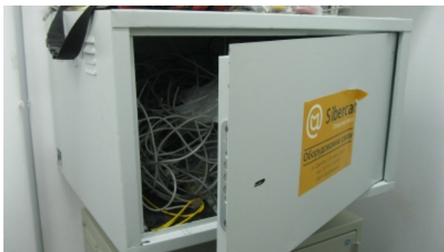
[Комната связи в новом доме]
