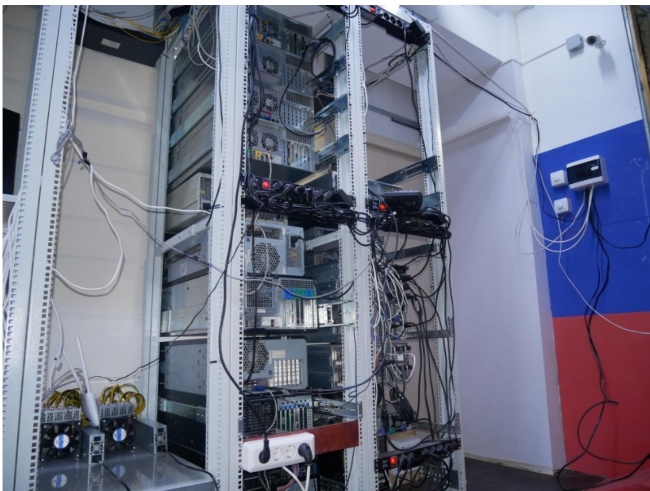
Так выглядят стойки с оборудованием со стороны "горячего" коридора:
