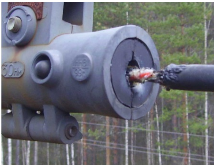
Рис. 1 Разрушение оболочки вследствие коронных разрядов
