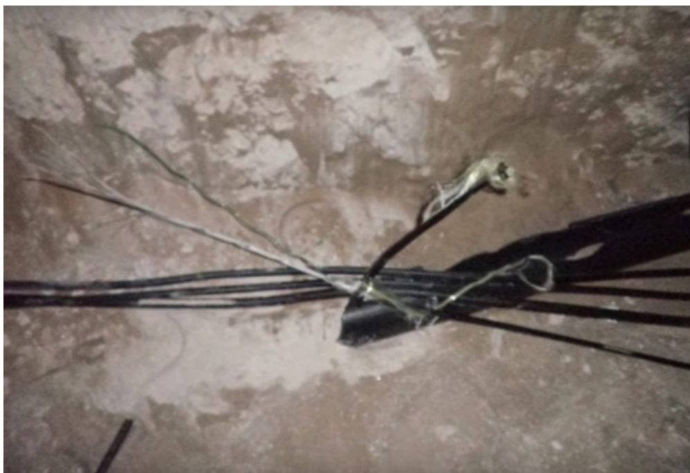
Рис. 3 Последствия работы баровой машины
