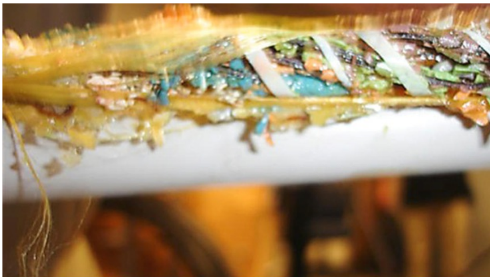
Рис. 12 Последствия разрушения кабеля от водяного пара вблизи теплотрассы
