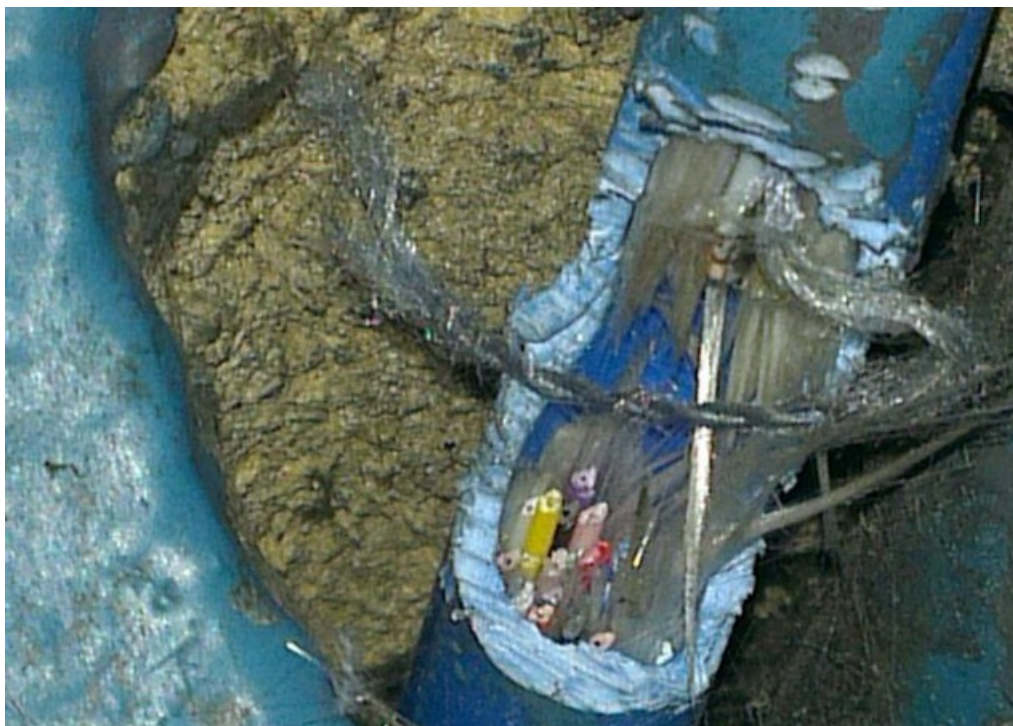
Рис.10 Повреждение оптического кабеля грызунами
