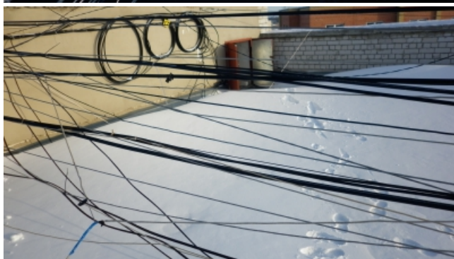
Базовая станция КТВ
