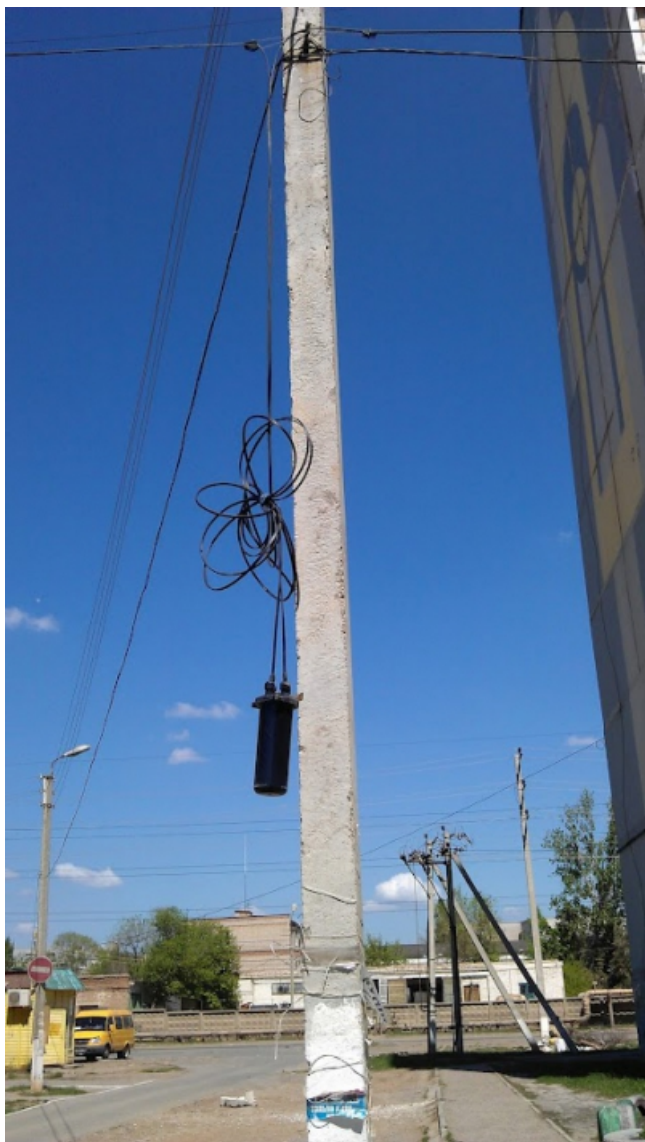
Плохо закрепленная муфта. (внутри все волокна разбиты в кашу).
