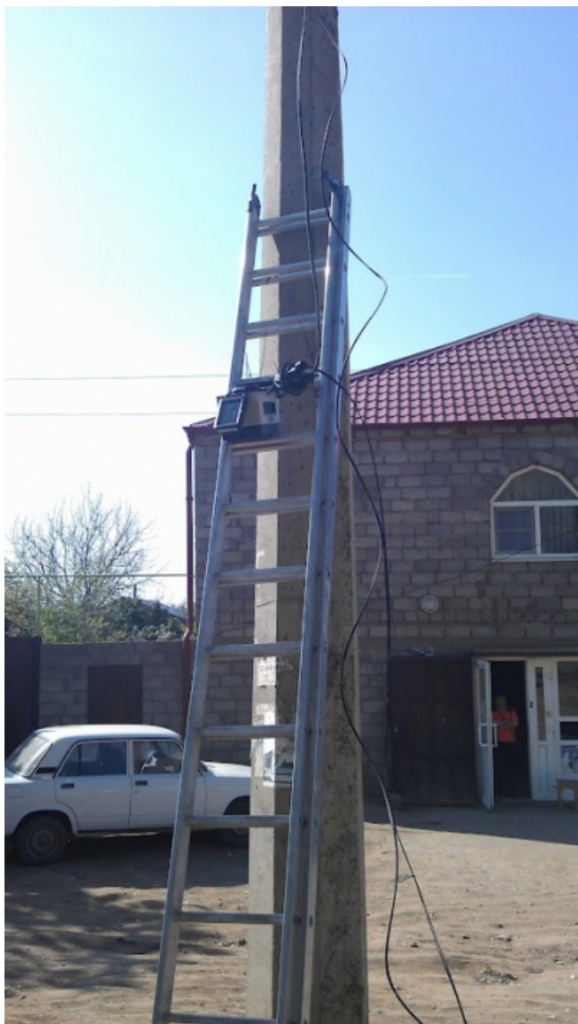
Муфта и сварочник прикреплены стяжками к лестнице.
