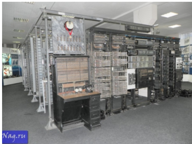
Фрагмент первой машинной телефонной станции, смонтированной в 1930 г. - раритет системы связи
