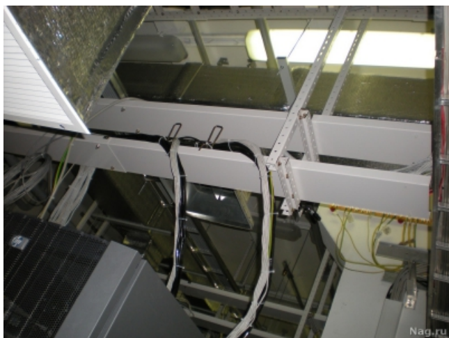
Держатели для кабельных кроссов, заземление и небольшие видеокамеры - весь потолок "утыкан" системами поддержки кроссов
