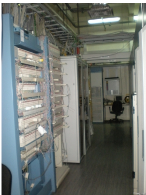
Таинственные помещения с сотовым коммутатором - все как в Санкт-Петербурге в помещении "Дельты-Телеком"
