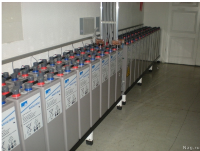
Аварийный запас - подключенные аккумуляторные батареи: отдельного помещения для их хранения не требуется, поэтому они спокойно стоят вдоль стенки
