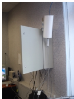
Типовой шкаф с термопокрытием и односекторная антенна Wi-Fi
