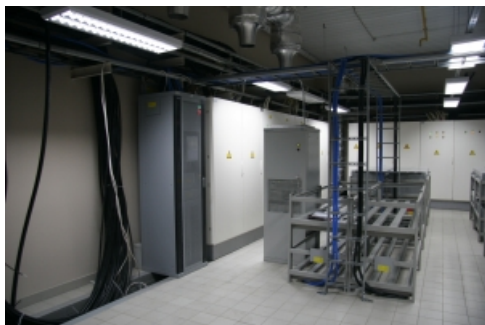
Зал ЭПУ, как и другие залы, заполнен примерно на половину – его будут наполнять оборудованием до 2012 г.
