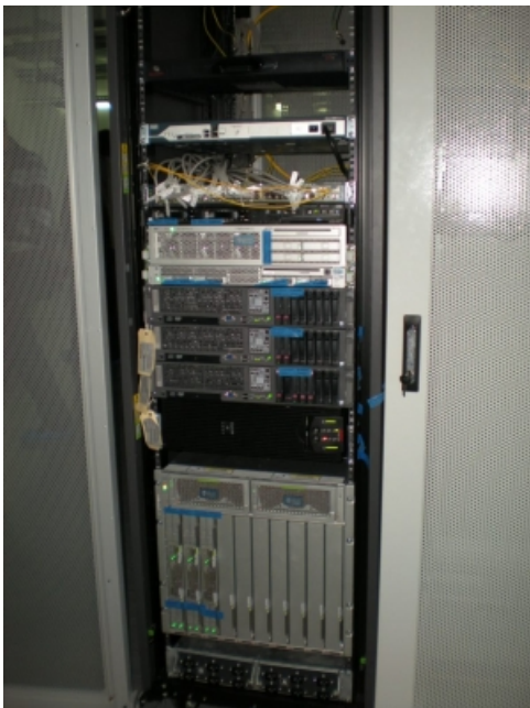
Стойки с оборудованием
