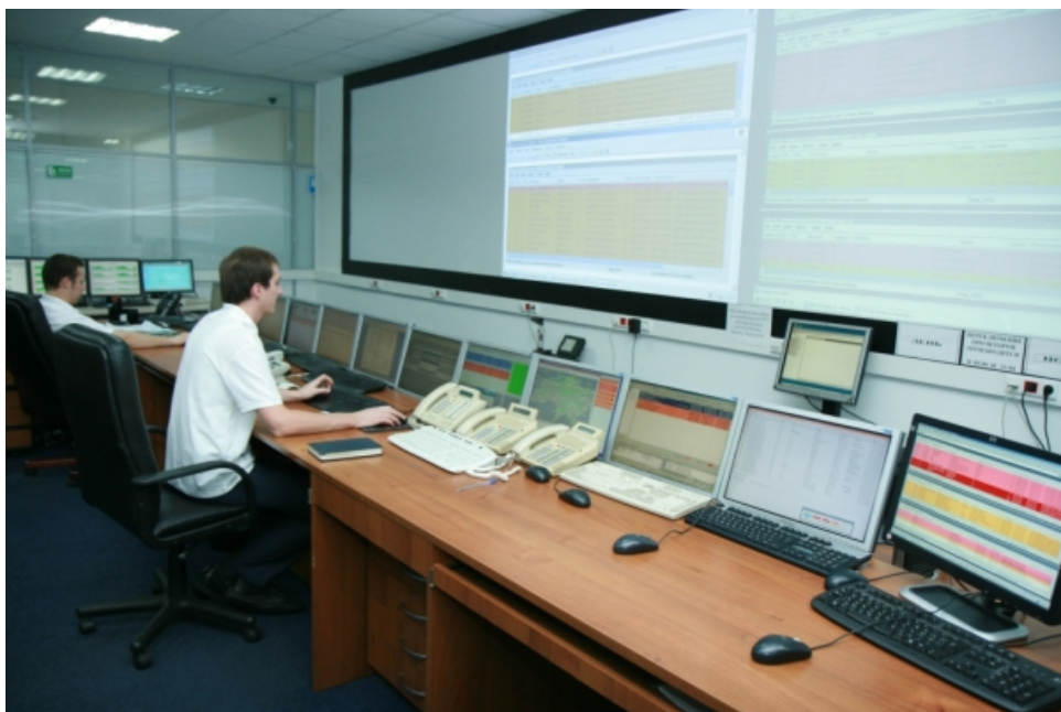
Центральная стена с тремя большими экранами позволяет получать данные о жизнедеятельности всей ИТ-системы оператора связи. Среди параметров, которые контролирует ЦУС, температура воздуха в помещении технической площадки.
